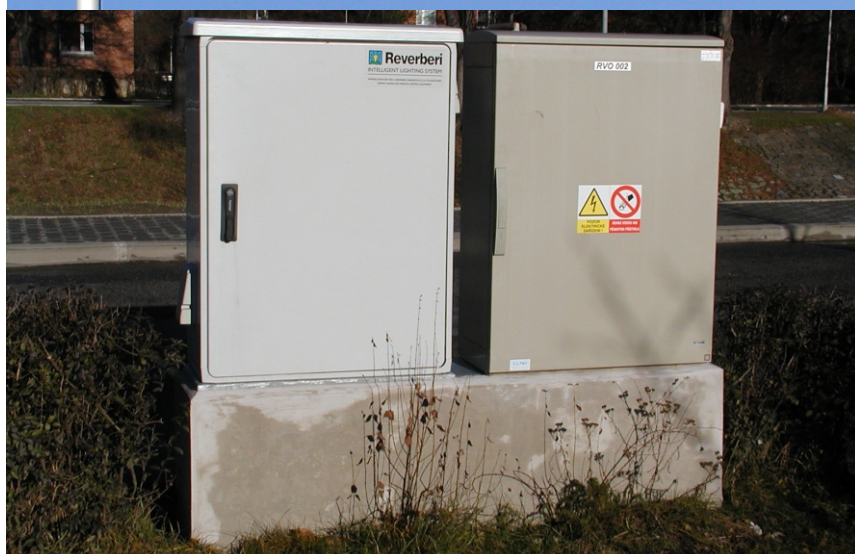
Instalovaný regulátor a RVO na betonovém soklu použité skříň výrobce Sarel a GE
